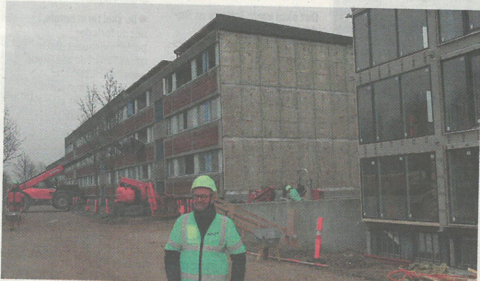
Palle Jørgensen, direktør i Boligforeningen Ringgården, mellem to blokke, der er ved at blive renoveret. Foto: Hans Petersen
